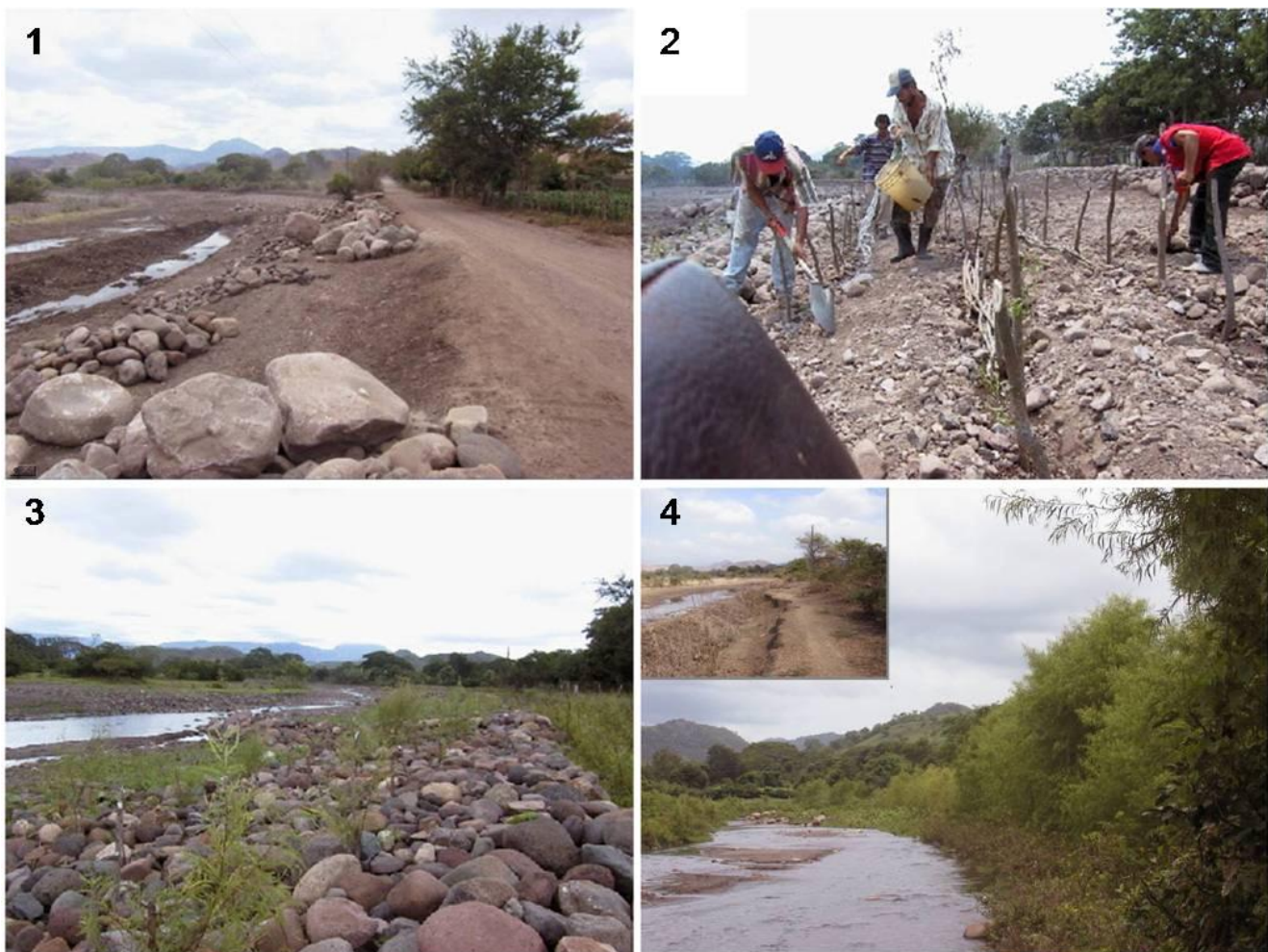
Figura 3. Ejemplo del trabajo de restauración (1-4 pasos del proceso) de la riveras de los ríos para la reducción de la vulnerabilidad desarrollados en Estelí, Nicaragua, 2001 (Trabajos y fotos del Ing. Robert Walle/Zamorano).
